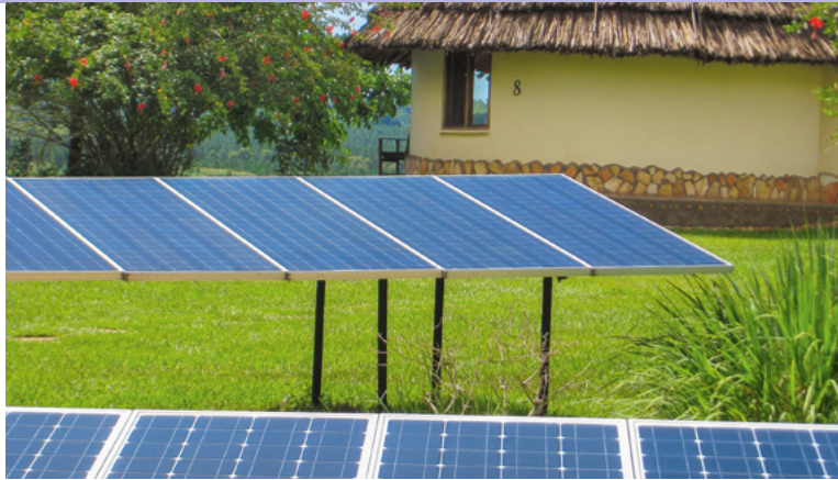
Sonnenkollektoren in einer ländlichen Gegend in Uganda
